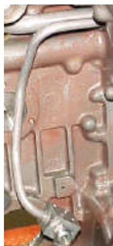
Schmierölleitung nicht korrekt (siehe SB 420-21).
